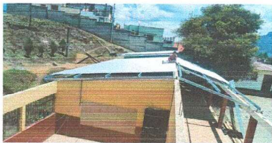
Foto1: TECHO EN MAL ESTADO
