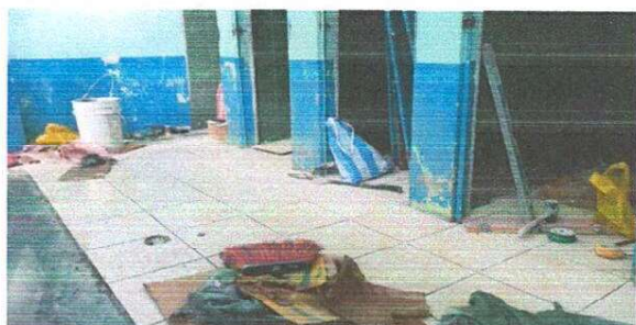
Foto 5: BAÑOS EN MAL ESTADO
